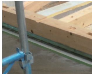
ノルシール土台気密パッキンの上から土台を設置します。
