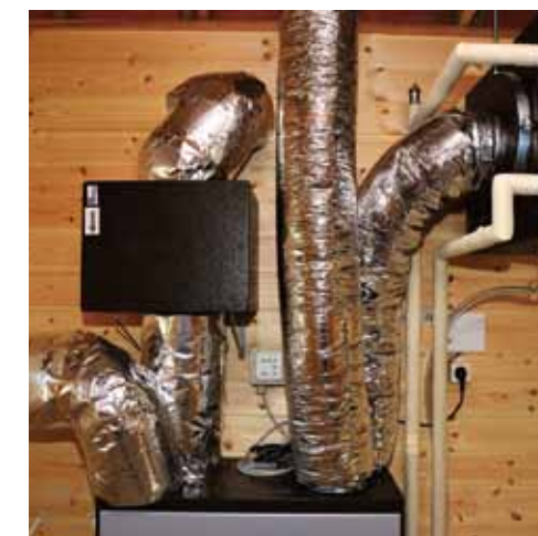
熱交換型換気システム設置状況
