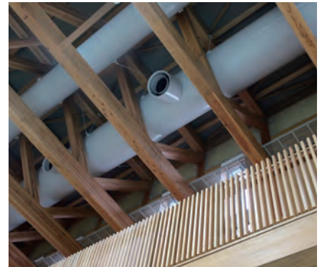
屋内露出ダクト
